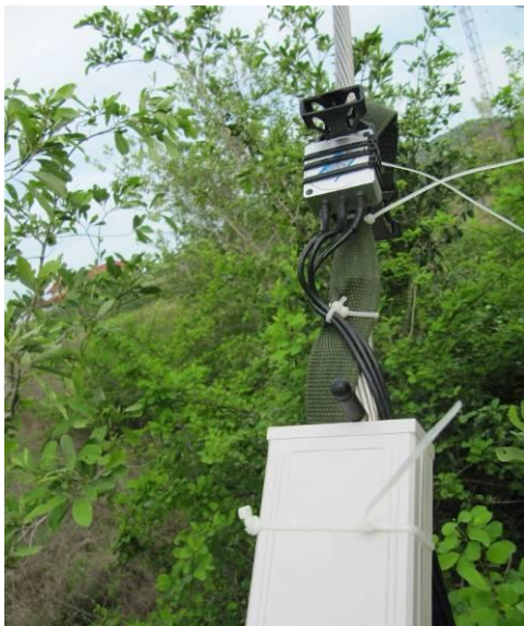
Hình 8.2 - Gắn cố định cảm biến đo dao động lên bề mặt dây cáp
